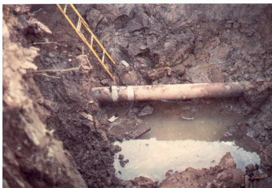
埋地管道泄露
